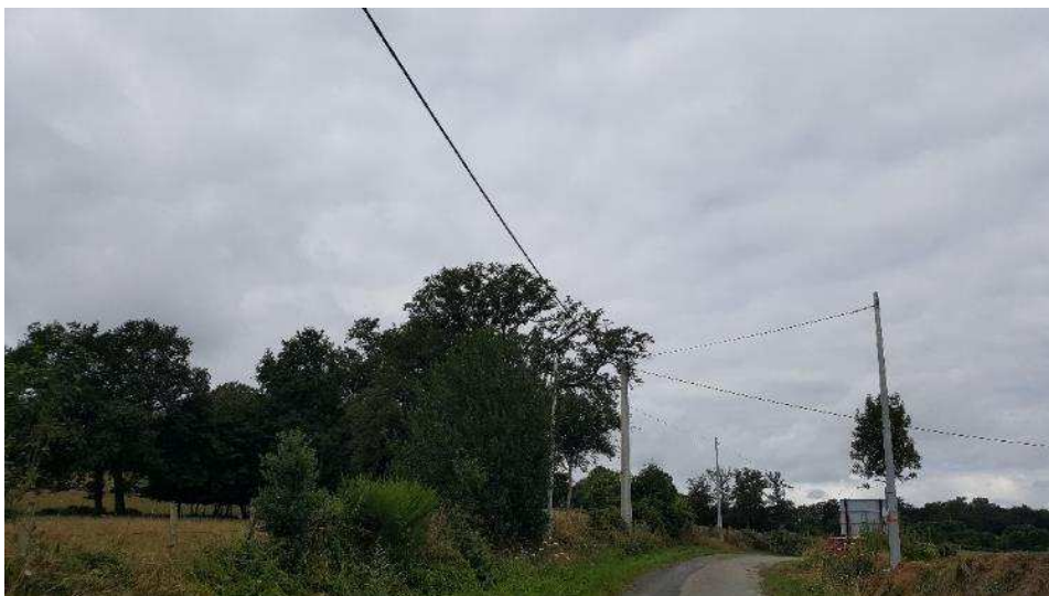
Réseau aérien du secteur
