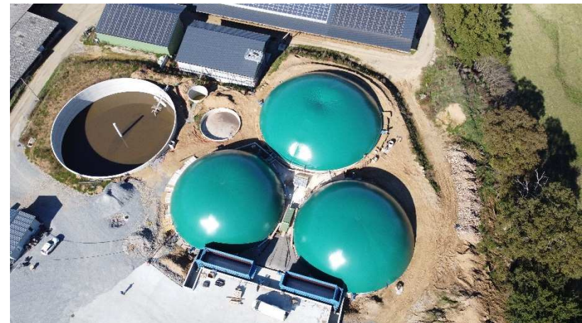
Situation de la zone process et des ouvrages enterrés au moment de la construction
