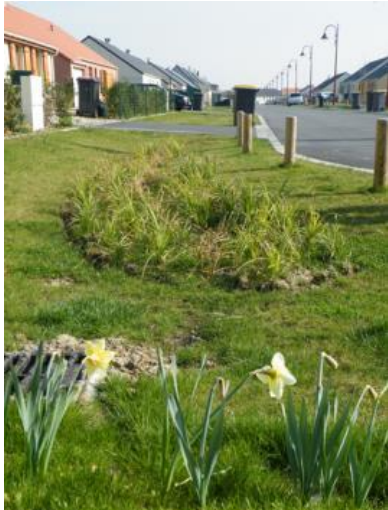
Les noues : ouvrages de rétention / infiltration des eaux pluviales
