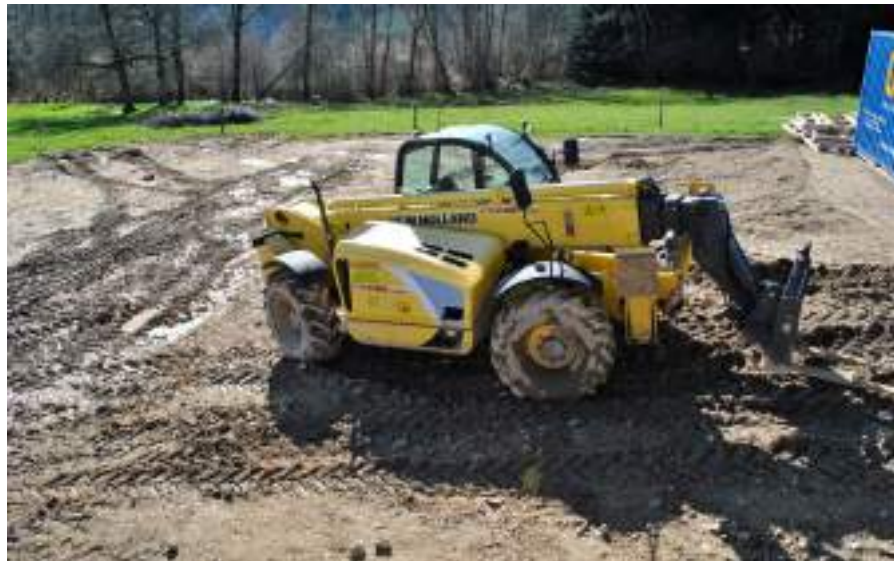
Photographie 31 : Exemple de tassement et d'ornières créés par les engins de chantier
