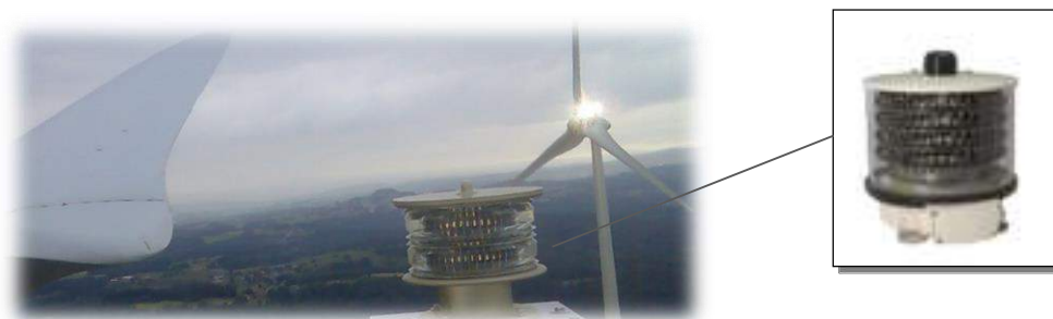
Figure 30 : Balisage d'une éolienne.
