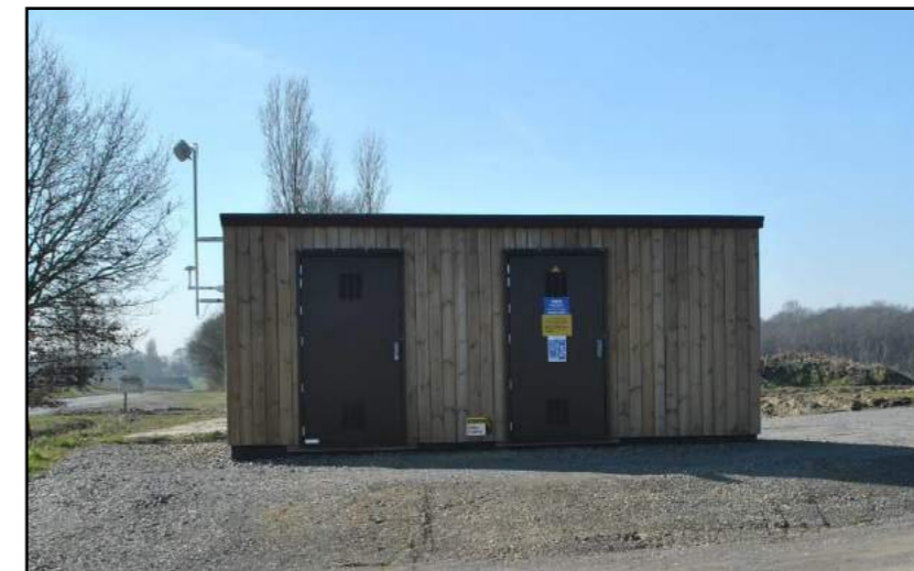
Photographie 120 : Exemple de poste de livraison habillé d'un bardage bois
