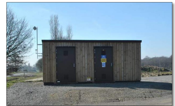
Photographie 121 : Illustration d'un poste de livraison avec bardage bois
