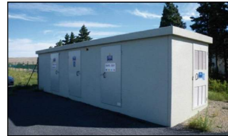
Photographie 119 : Exemple de poste de livraison "brut"
