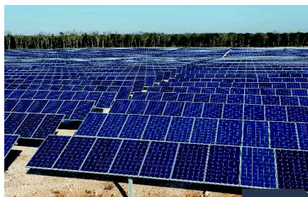
Parc solaire avec trackers Vallérargues (30) - Foncier communal Développement, Financement, Construction et Exploitation
