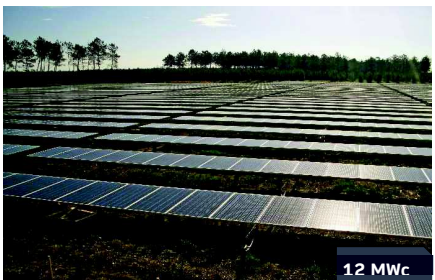
Parc solaire avec trackers Sainte Héléne (33) – Foncier communal Développement, Financement, Construction et Exploitation
