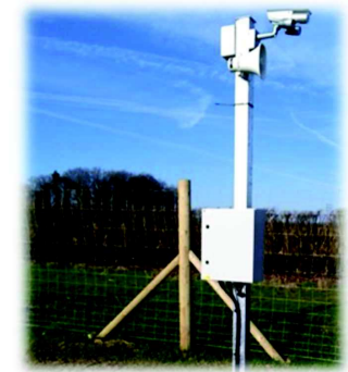
Exemple de dispositif de sécurité d'une clôture
