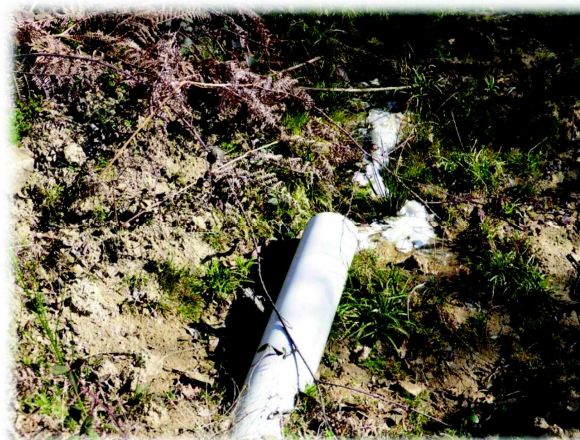
Exutoire de la canalisation en limite est du site (@ ECTARE)
