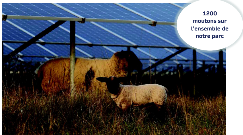
Ici la centrale solaire de Buzet en Haute-Garonne.
