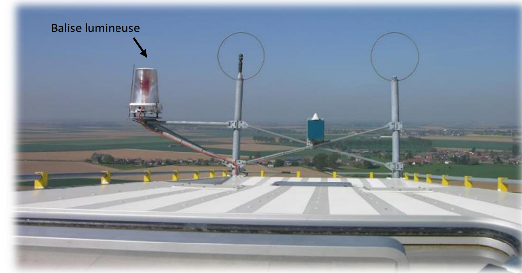
Figure 28 : Système de balisage lumineux (Source : ECOTERA)
