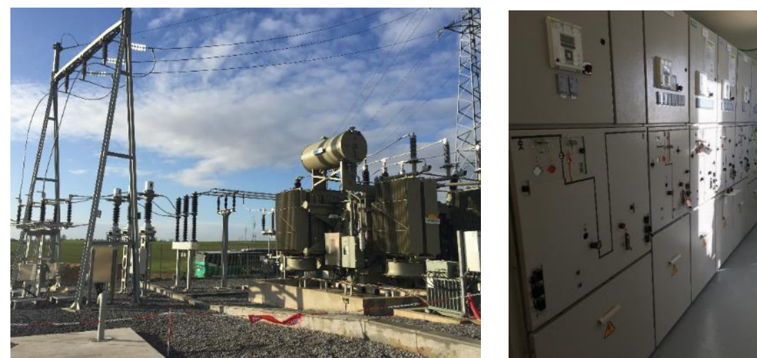
Figure 22 : Exemple de l'extérieur d'un poste source (gauche) et de l'intérieur (droite) (Source : EOLISE)
