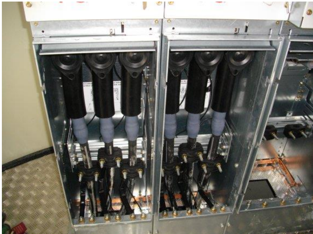
Figure 7 : Têtes de câbles isolées
