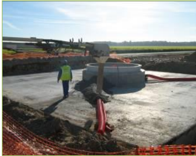
Photographie 5 – Coffrage de la cage d’ancrage et des câbles (source : Siemens Gamesa)
