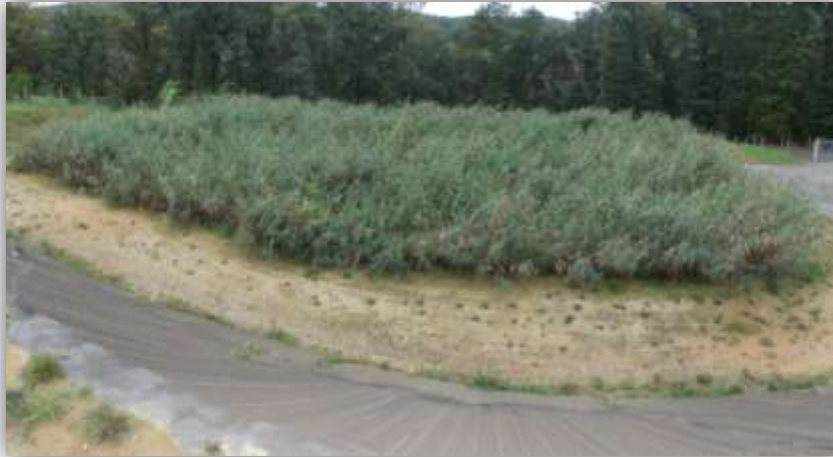
PHOTO 11 : FILTRE PLANTE DE ROSEAU SECOND ETAGE- BOURG
